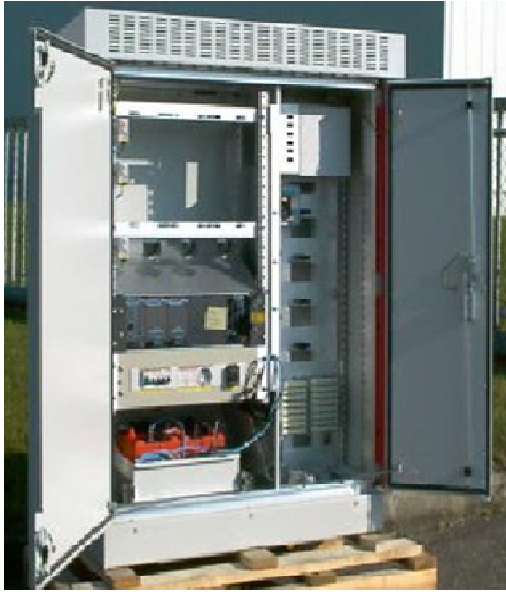
Figure 1. Armoire réelle de télécommunication.
