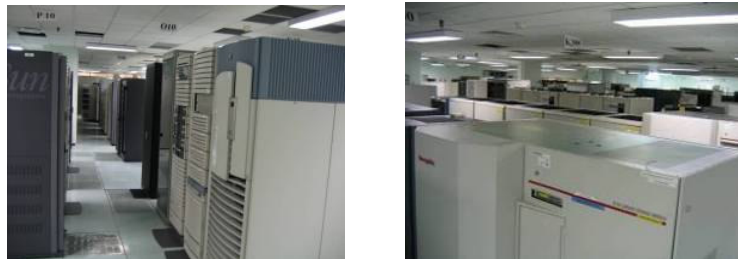
Figure 2: Vues de l'intérieur d'un Datacenter
