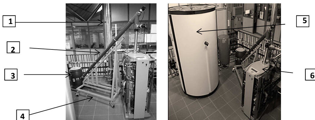
Figure 2 : Banc d'essais du micro cogénérateur BISON sur la plateforme énergétique de l'INSA de Strasbourg (1: cheminée, 2: vis sans fin d'alimentation en pellets, 3: réservoir de pellets, 4 : support de la vis sans fin, 5: ballon tampon de 1500 l, 6 : micro cogénérateur).
