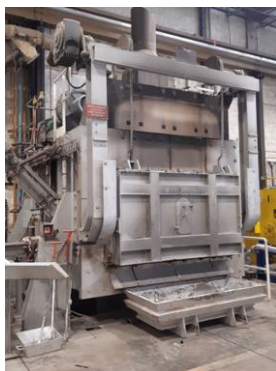
Figure 1 : Photo du four réverbère équipé d'un brûleur gaz naturel (configuration actuelle).
