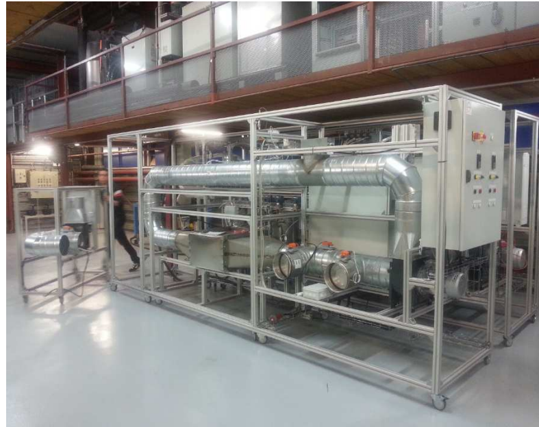
Photographie du banc d'essai TRANSPAC 20-05/2014 CES palaiseau
